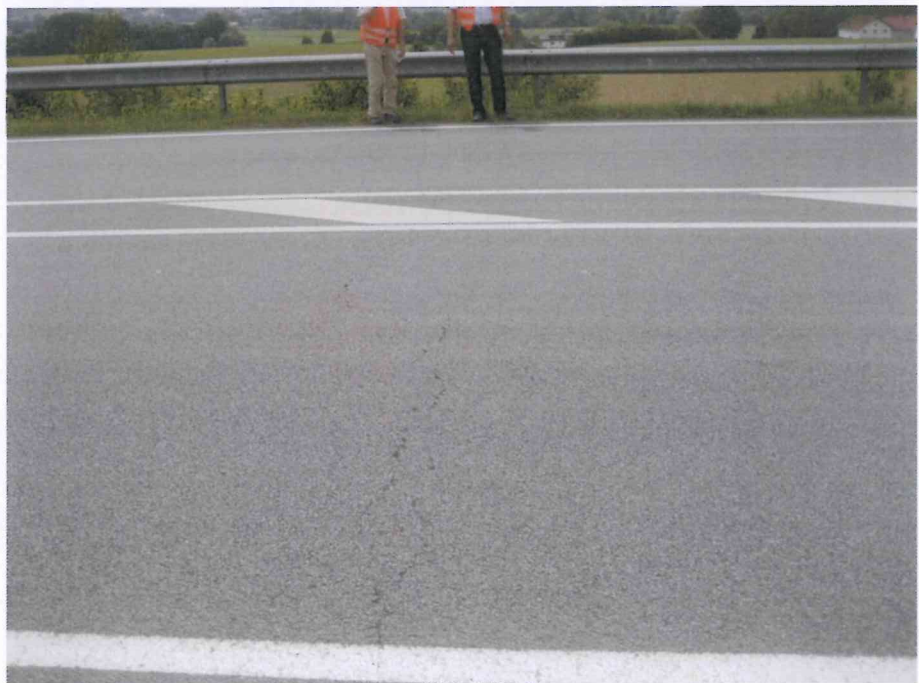
Bild 4: Abschnitt 1120 Station 0,058: Quer zur Fahrtrichtung verlaufender Riss, Entnahmestelle Bohrkern Nr. 2 (NV)
