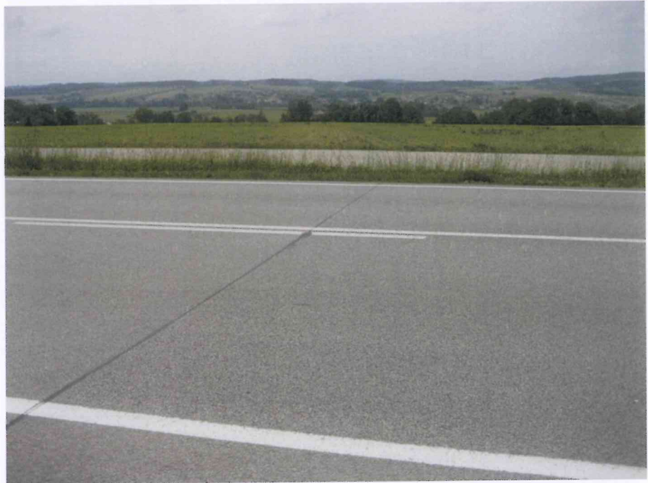
Bild 5: Abschnitt 1120 Station 0,502 Tagesarbeitsnaht im Abschnitt mit Mischfüller; offener Abschluss rechts und dichter Ansatz links, bisher keine Beschädigung
